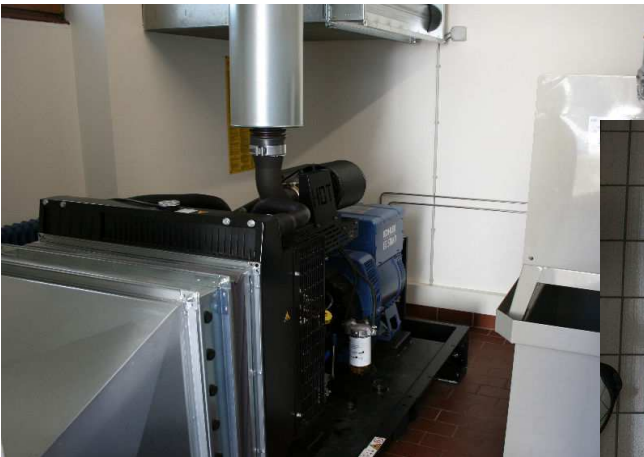
NEU: Notstromaggregat Gerätehaus
