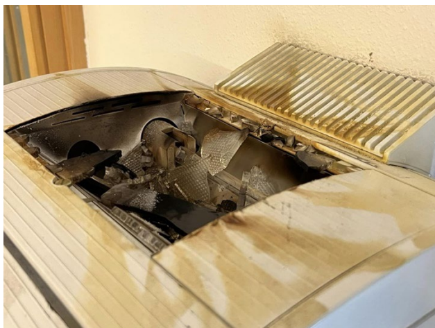
Nachkontrolle nach Brand auf einer Beleuchtung im Weilheimer Krankenhaus.
